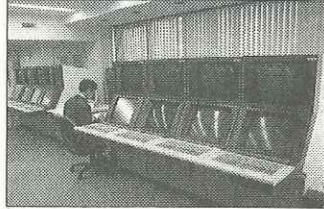
当社・社内設置DCSシステム一例 DCS/PLC盤、工事も一括で エンジニアリング施工
